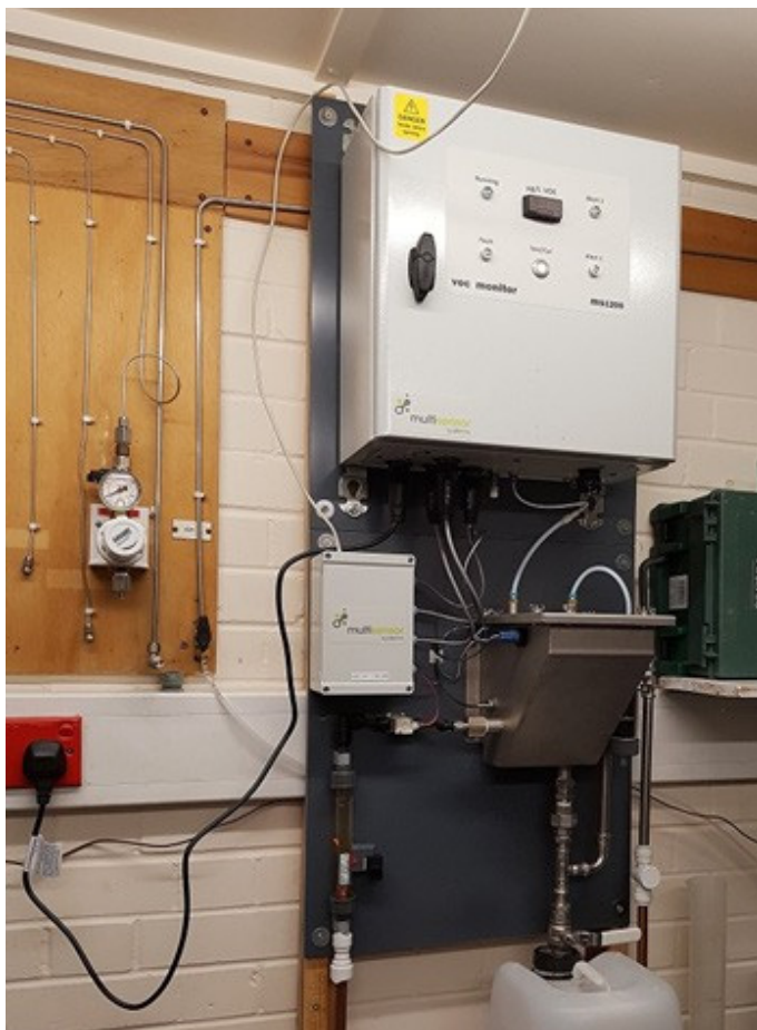
図 13. 別棟に設置されたユニットの写真。設置された装置は PLC に接続されており、PLC は逐次データを保存し、事故が発生した場合にアラームを作動させて取水口のポンプのスイッチをオフにする。
