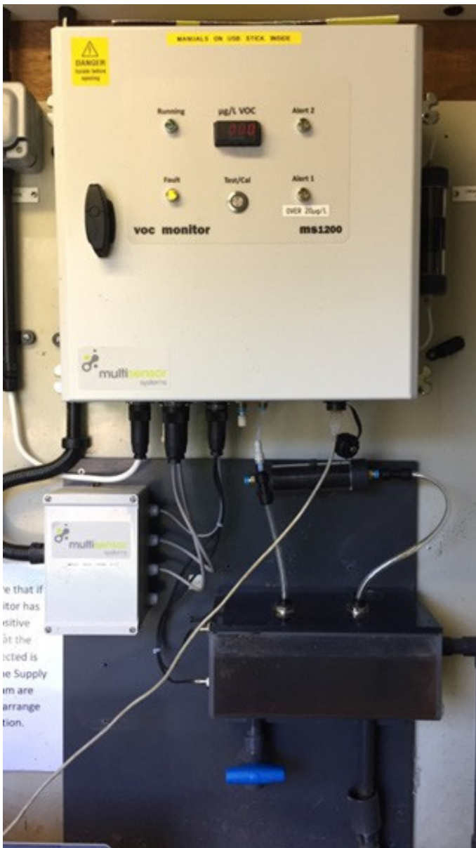
図 14. — 別棟に設置されたユニットの写真。このユニットは、汚染が発生した場合に貯水池から流れを逸らす水門を制御。
