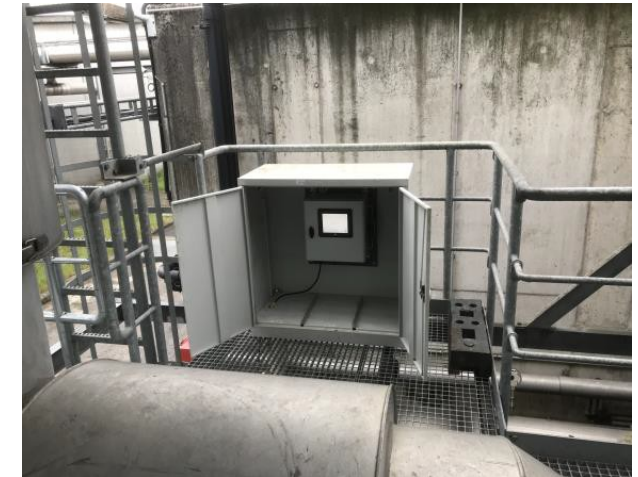
厳しい環境から保護するための キャビネット内に設置された装置
